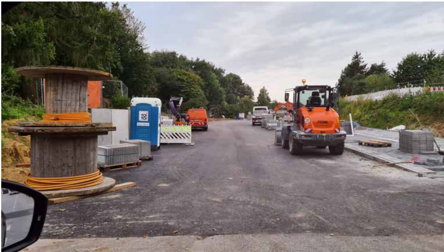
So sah der Baufortschritt der neuen Zufahrtsstraße vor knapp zwei Monaten aus.
